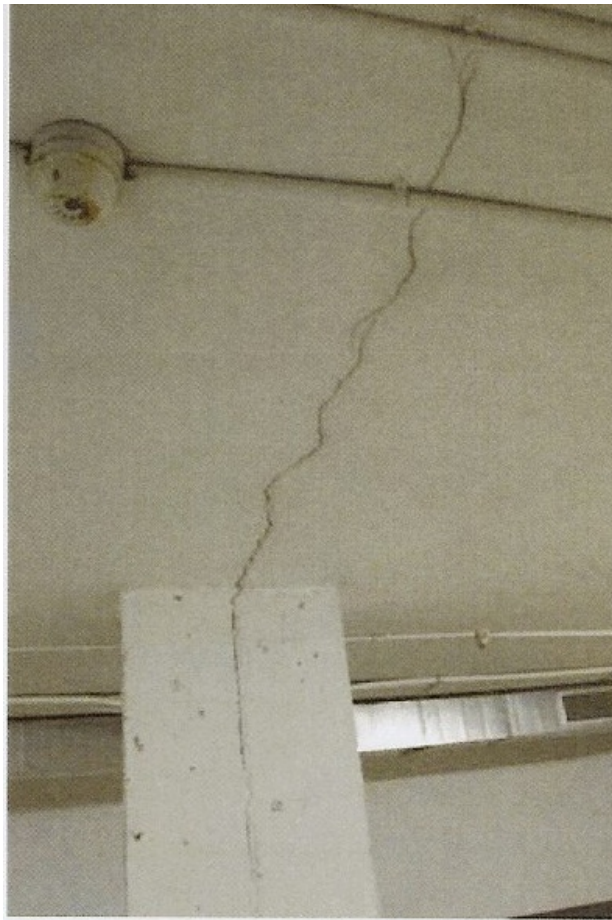
Foto 37: fisura techo Bloque 1
