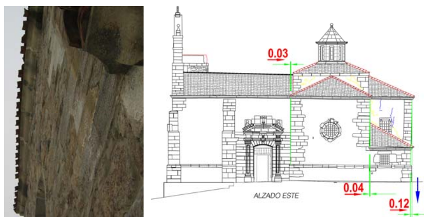
Fig. 31: Abombamientos en el muro Este
