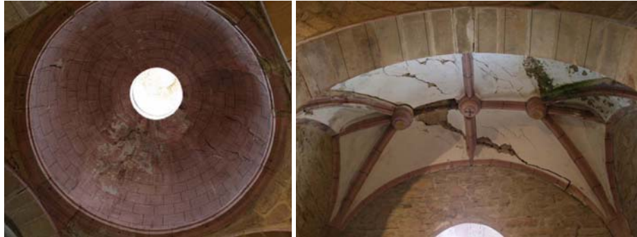
Fig. 34 y 35: Agrietamientos en cúpula y en bóveda Este
