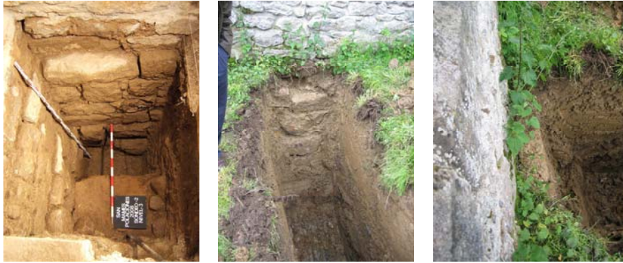
Fig. 22: Recrecidos en la cimentación, lado interior, del muro Este (sondeo 2). Fig. 23 y 24: Recrecidos en la cimentación, lado exterior, del muro Norte.
